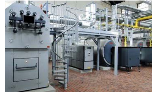
Holzheizsystem, BHKW, Gasheizkessel
