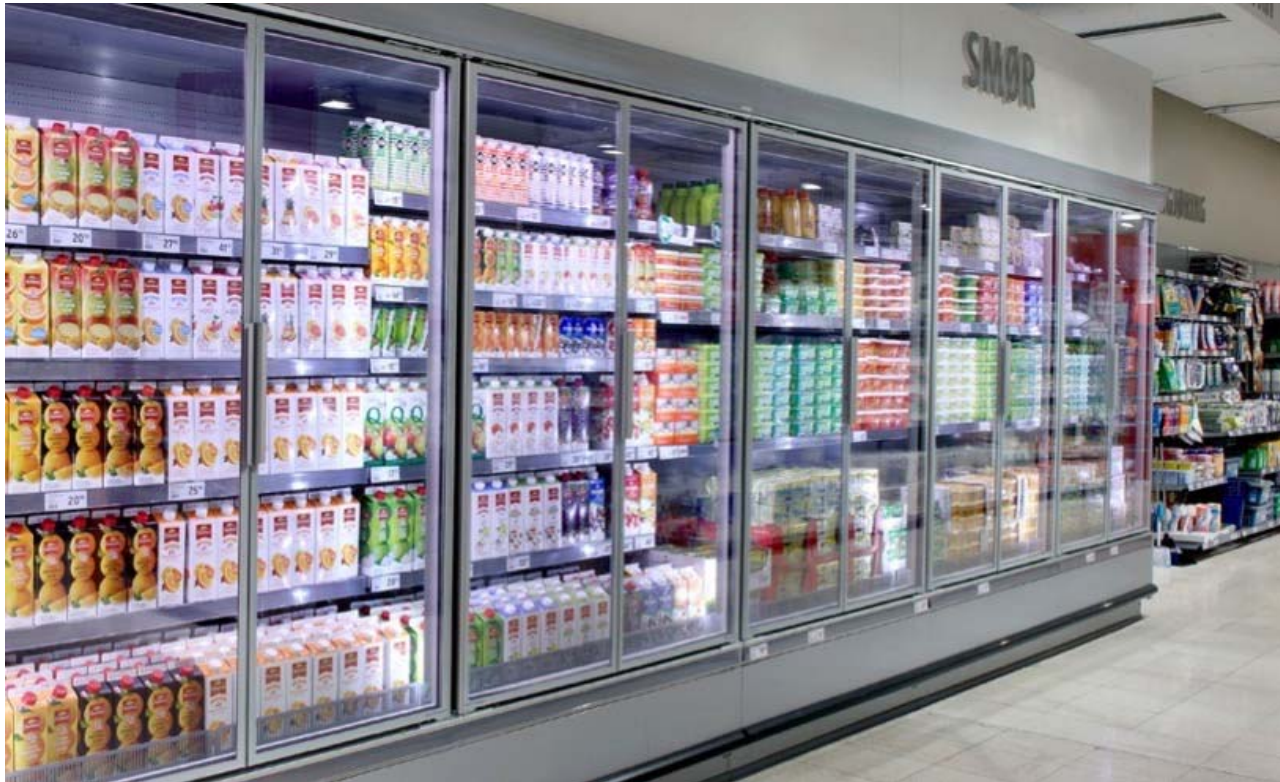
Energieeffiziente Kühlmöbel für den Lebensmittel-Einzelhandel
