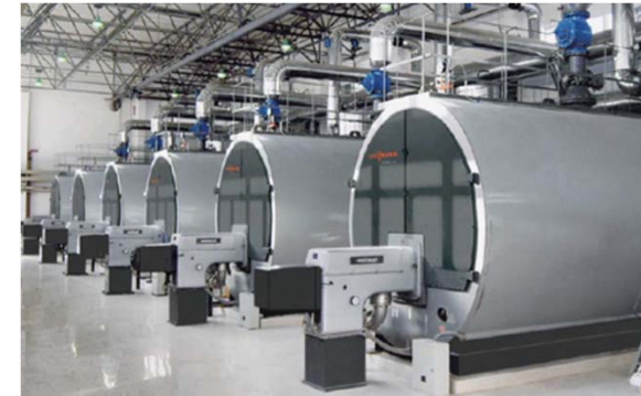
Heißwasserkessel mit Gasbrennern
