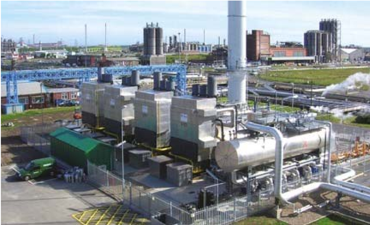
Dampfkesselanlage, Sembcorp (UK)
